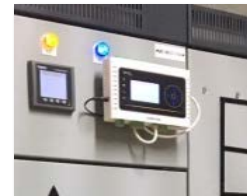
4. อุปกรณ์ควบคุมตู้สวิตช์บอร์ด และ อุปกรณ์แสดงผลพร้อมชุดเก็บข้อมูล
